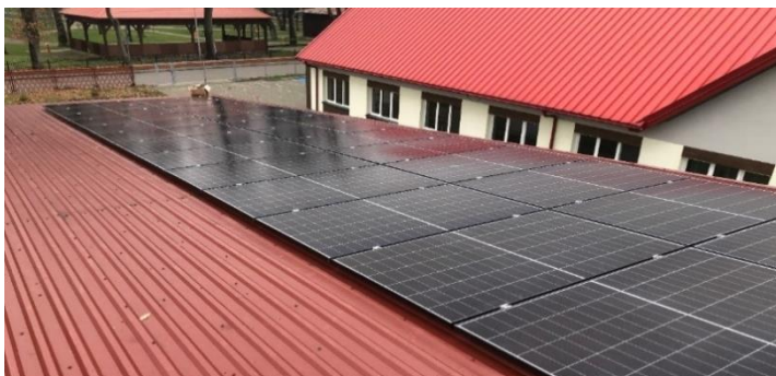
Fot. Instalacja fotowoltaiczna na dachu strażnicy OSP w Szczuczynie
