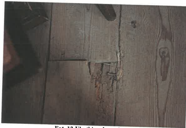
Fot. 12 Ubytki w drewnie (8)
