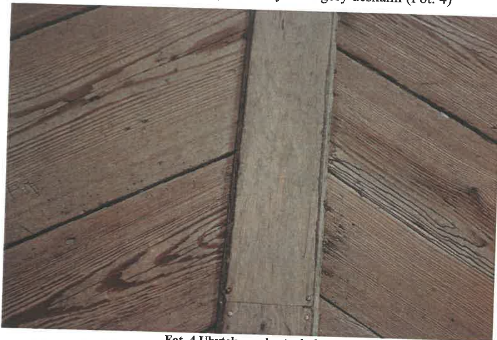
Fot. 4 Ubytek przykryty deską
