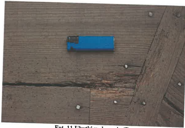
Fot. 11 Ubytki w drewnie (7)
