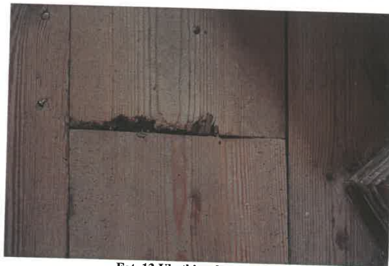
Fot. 13 Ubytki w drewnie (9)
