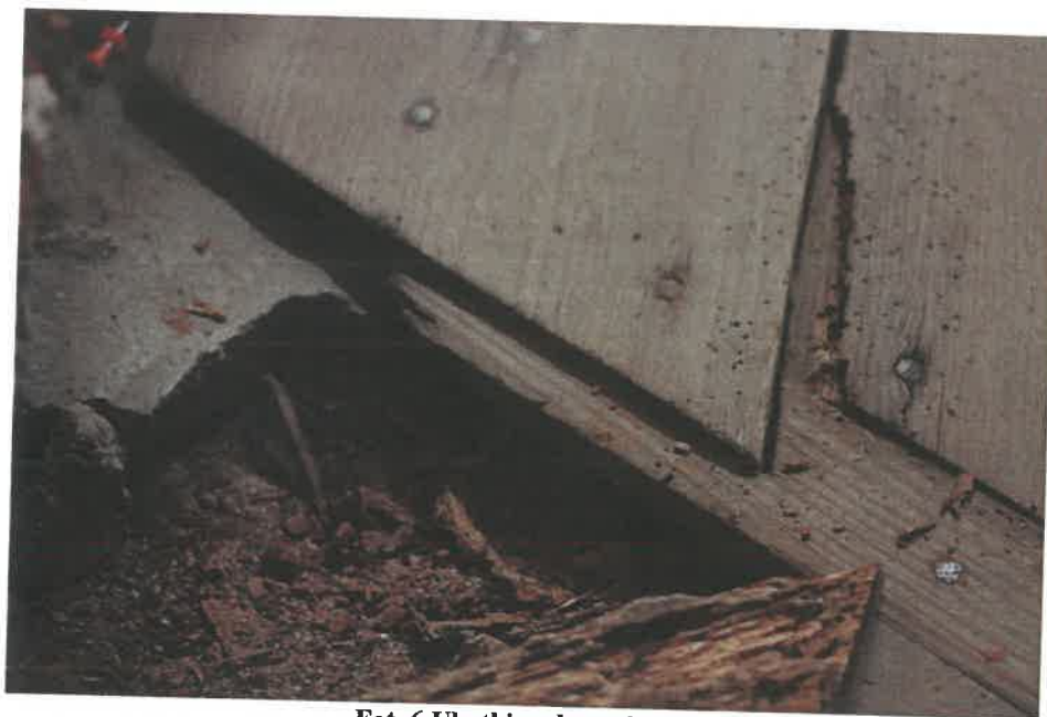
Fot. 6 Ubytki w drewnie (2)
