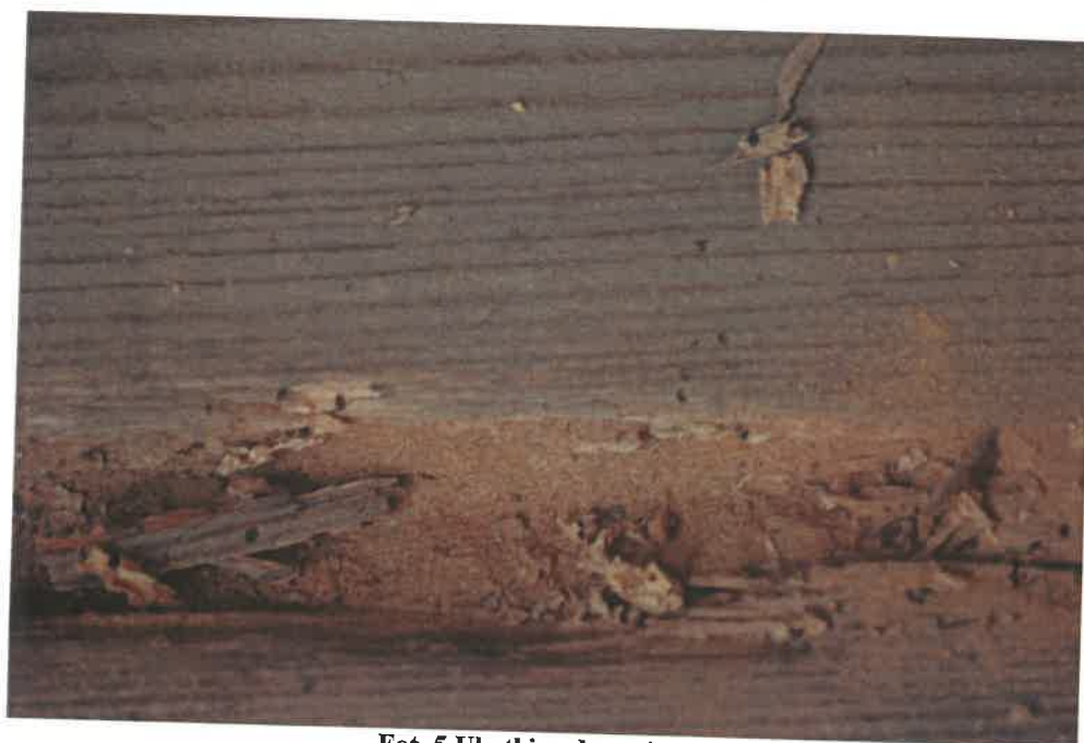
Fot. 5 Ubytki w drewnie (1)
