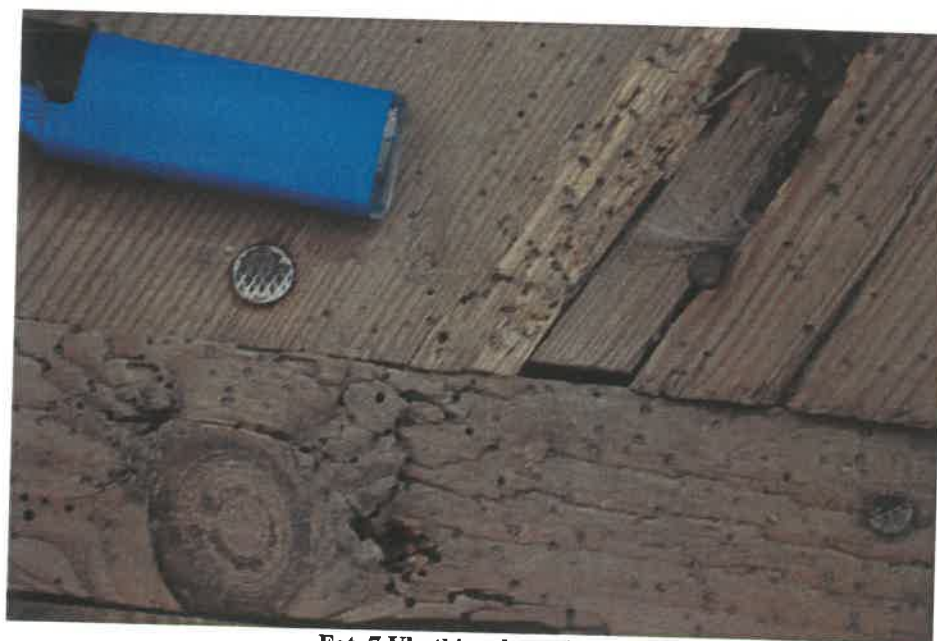
Fot. 7 Ubytki w drewnie (3)
