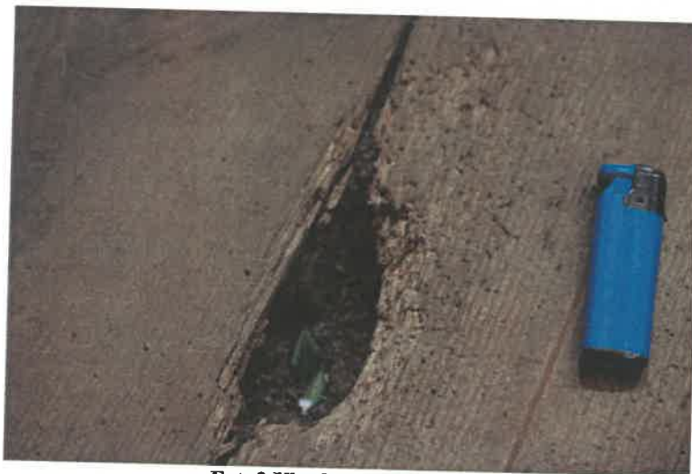
Fot. 9 Ubytki w drewnie (5)
