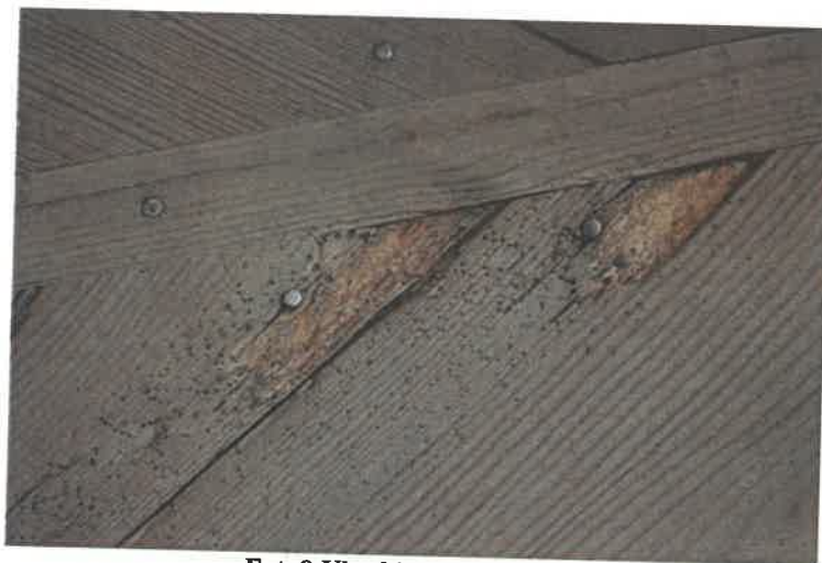
Fot. 8 Ubytki w drewnie (4)
