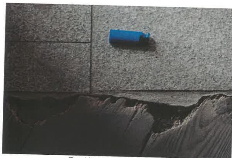
Fot. 10 Ubytki w drewnie (6)
