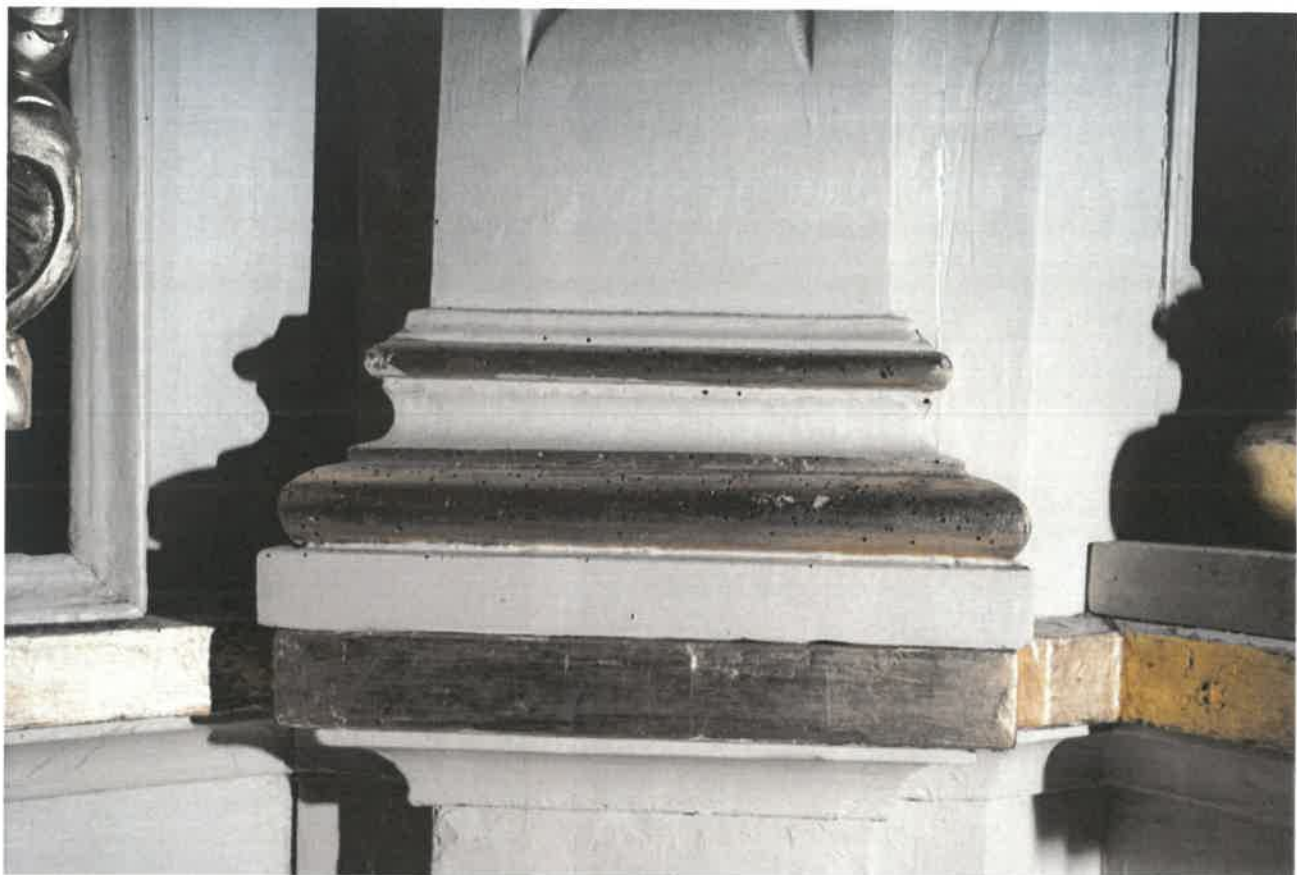
Zbliżenie na cokół pilastra ołtarzowego. Widoczne liczne otwory świadczące o żerujących w drewnie ksylofagach niszczących strukturę drewna.
